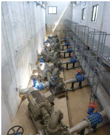
Estación de bombeo principal
